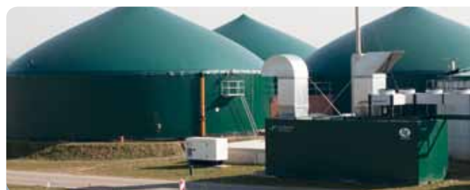
In drei Gärbehältern entsteht in Schönhagen Methangas und wird gleich vor Ort in Strom umgewandelt.
